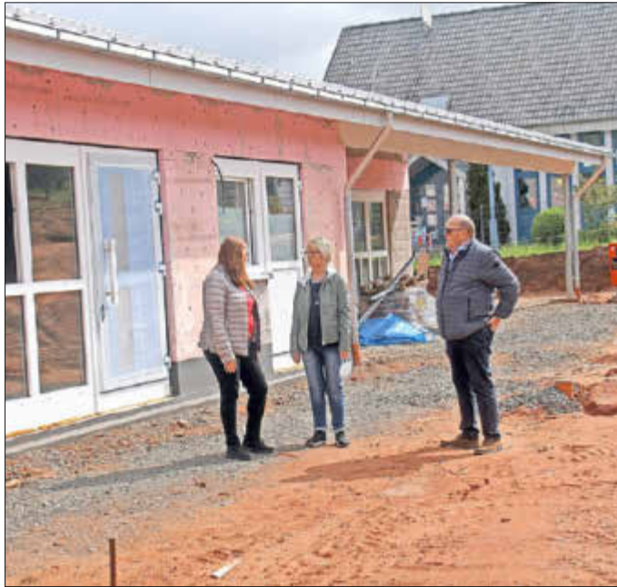
Die künftige Leiterin der Kindertagesstätte Bettina Klemm und die beiden Stadtbeigeordneten Gisela Pfaff und Ludwig Linsmayer (v.l.) informierten sich vergangene Woche über den Stand der Bauarbeiten in Miesenbach (Fotos: St. Layes).
