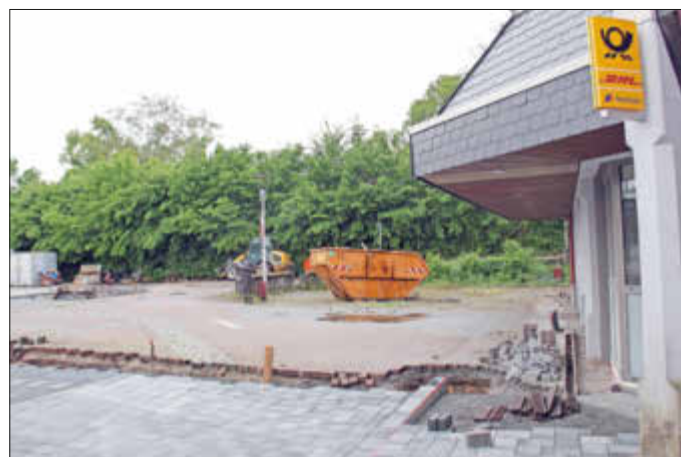
Für den letzten Bauabschnitt am Congress Center Ramstein musste der Zugang zur Postagentur und Geschäftsstelle verlegt werden (Foto: St. Laves)
