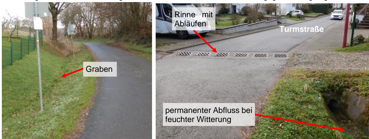
Abbildung 47 Außengebietswasserfassung Turmstraße Bilder 16.01.2023
