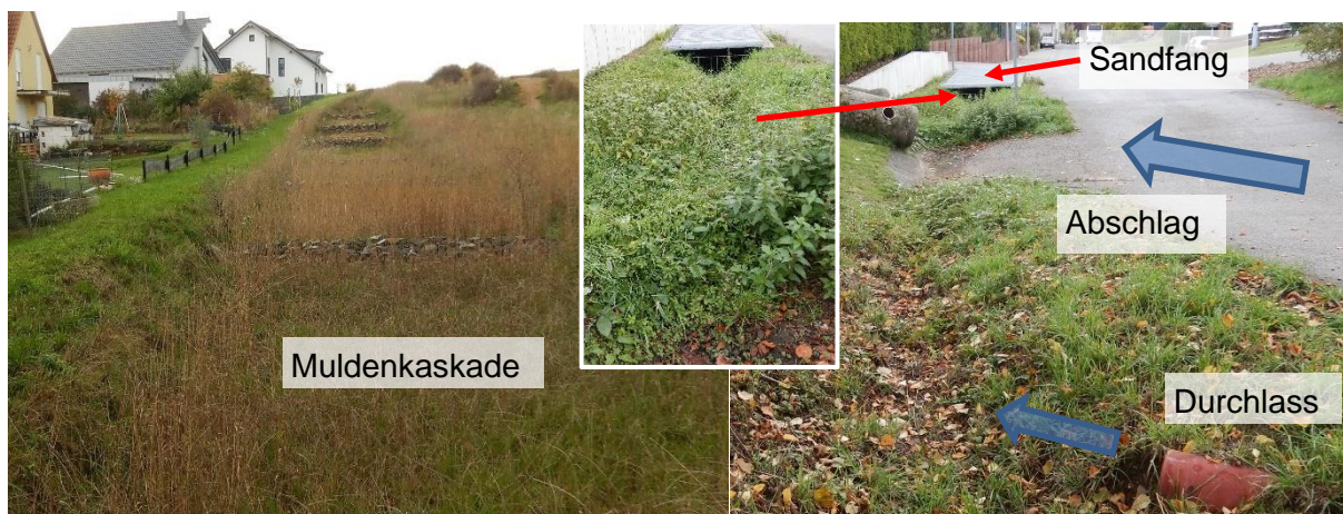
Abbildung 40 Kaskade und Fassung Außengebietswasser Triftstraße
