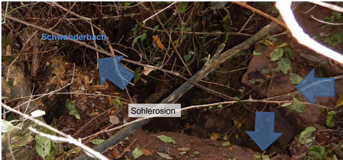
Abbildung 10 Sohlerosion Schwanderbach Bereich Brunnenwiese
